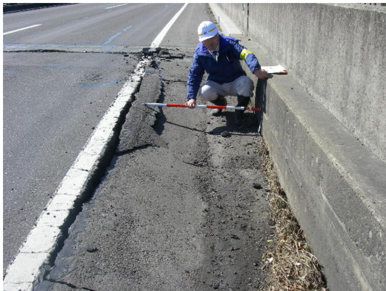
国道4号 須賀川南大橋(212.3Kp) 陥没状況
