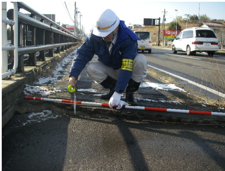
国道4号 滑川橋(217.6Kp) 段差状況確認
