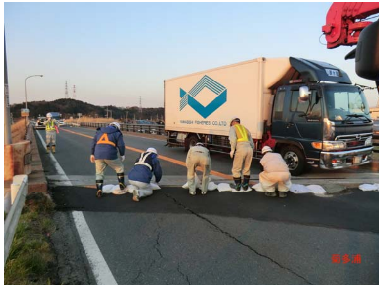
国道 6 号 段差応急復旧（土のう設置状況）
