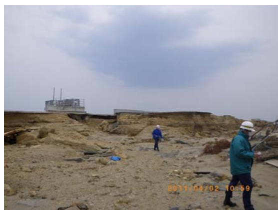
防波堤被災状況確認 (4/2)
