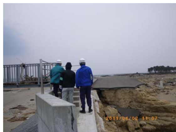
防波堤被災状況確認 (4/2)
