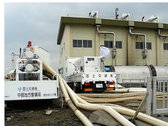
排水ポンプ車稼働状況 (4/11)
