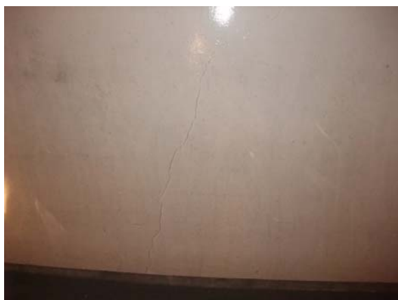
鵜波トンネル内ひび割れ
