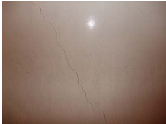
鵜波トンネル内ひび割れ
