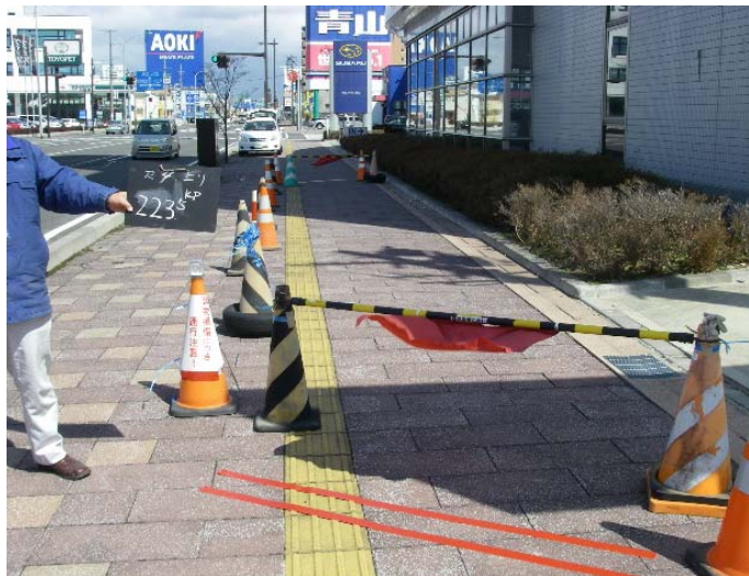
国道4号 223.5KP 上り線 郡山市川向地内 ビルの外壁材落下の恐れ
