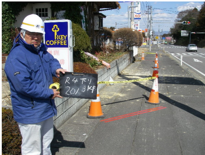
国道4号 201.3KP 下り線 西白河郡矢吹町地内 瓦落下の恐れ
