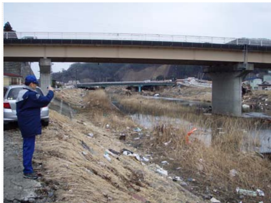
大槌川被災状況 (3/23)
