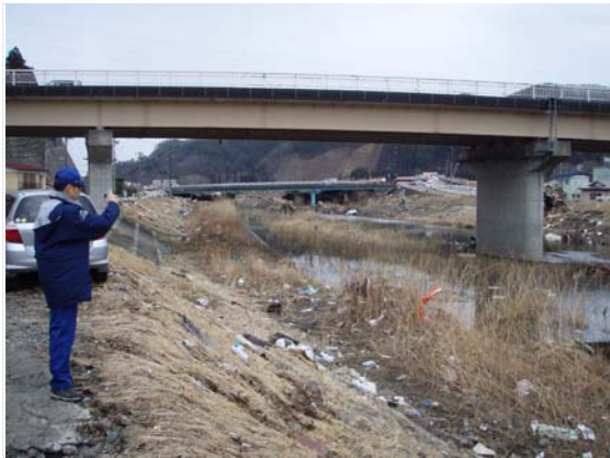
大槌川被災状況 (3/23)
