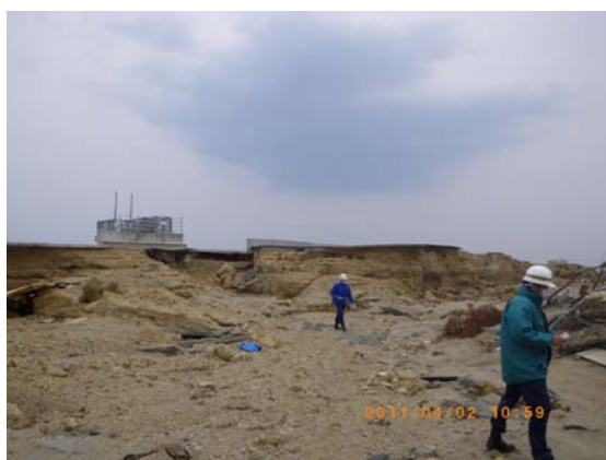
防波堤被災状況確認 (4/2)
