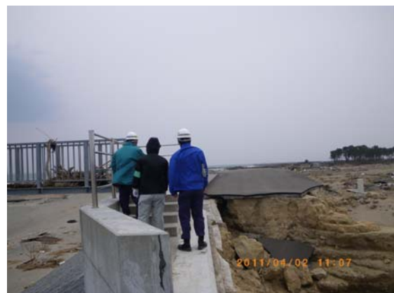
防波堤被災状況確認 (4/2)
