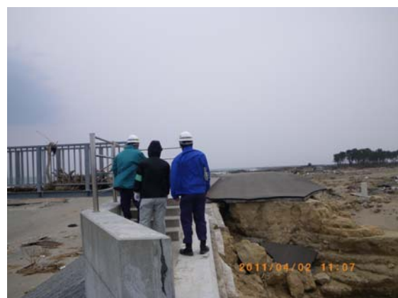
防波堤被災状況確認 (4/2)
