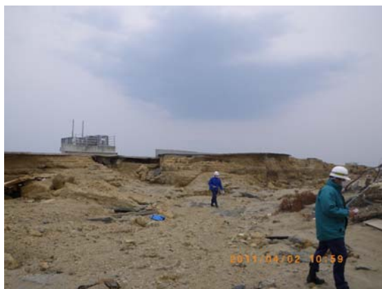
防波堤被災状況確認 (4/2)
