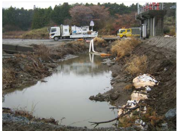
排水ポンプ車稼働状況 (4/23)
