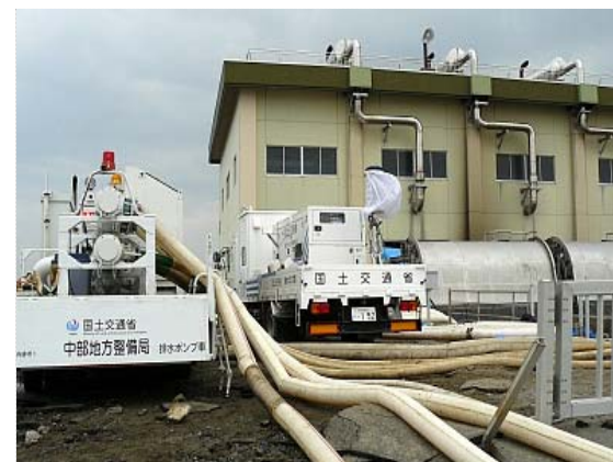
排水ポンプ車稼働状況 (4/11)
